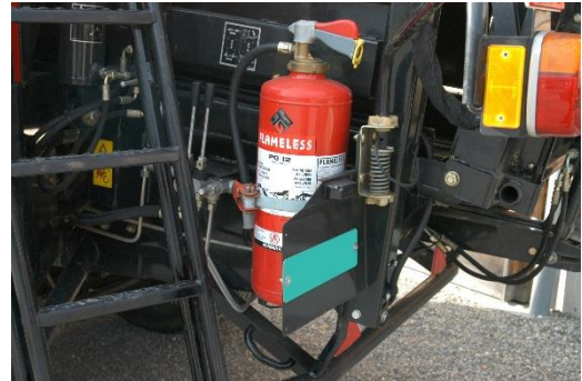
Löschmittel auf der Maschine sollten in ausreichender Menge vorhanden sein. Bild: BUL
